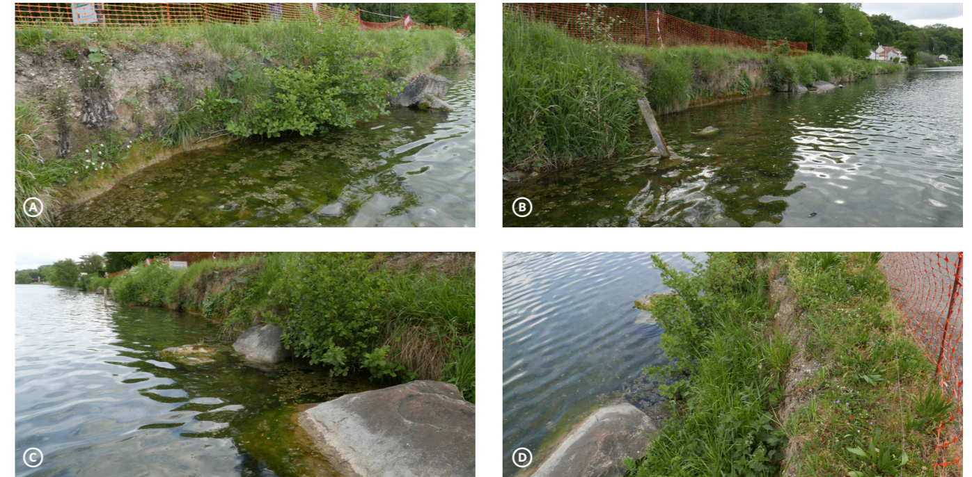
Figure 3 Illustrations des faciès d'érosion au droit des trois premiers tronçons d'étude et des infrastructures menacées (essentiellement les voiries et équipements de la rue des Berges de Seine) (clichés Biotec – 28/04/2020).
