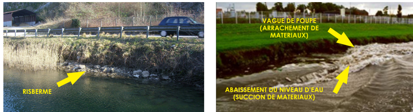
Figure 9 Effets caractéristiques du phénomène de batillage en bordure d'un cours d'eau navigué (la Lys, image de droite). Illustration du processus de sapement de berge, en rive gauche du canal de Savières le long de la RD 18 (image de gauche). Biotec – 2008.28.01.
